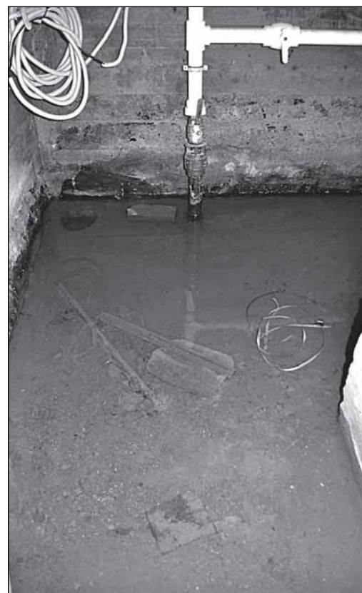
Вверху: в подвале стоит вода Слева: через такую кровлю воде тоже нетрудно попасть в дом
