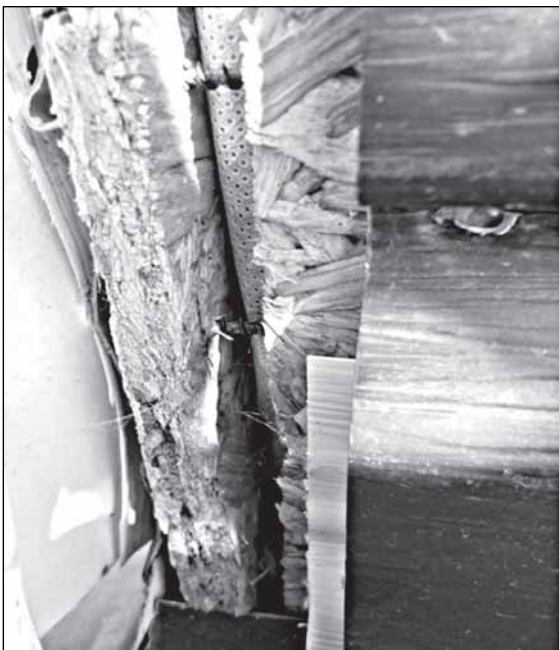
Угловое крепление OSB-панелей без брусков, щели, дыры обшивки, отсутствие влагозащитных плёнок.
