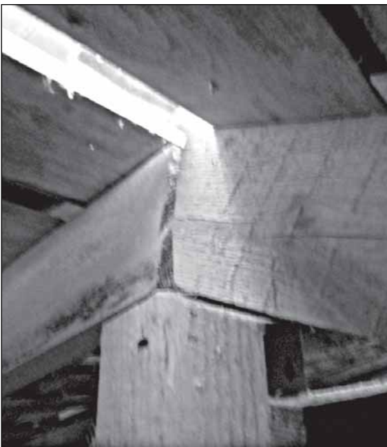
Разъезжающиеся стропила, отсутствие должного крепления деревянных элементов крыши. Пластин крепления нет.
