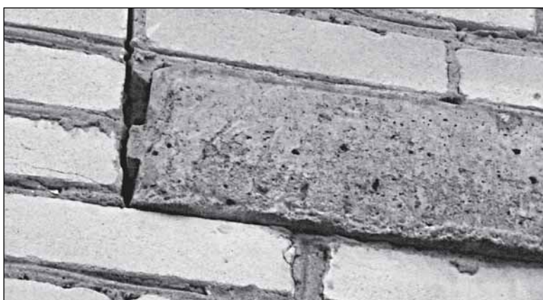
В стенах - трещины, кирпичи вываливаются
